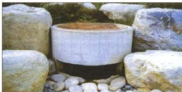
Fot. 1 Betonowa studnia chłonna
